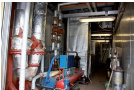
Рис. 2. Оборудование для приточно-вытяжной вентиляции модулей
